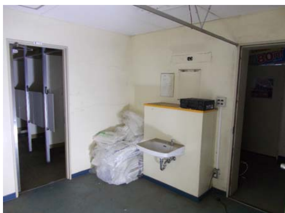
改修前（老朽化したシャワー室）
